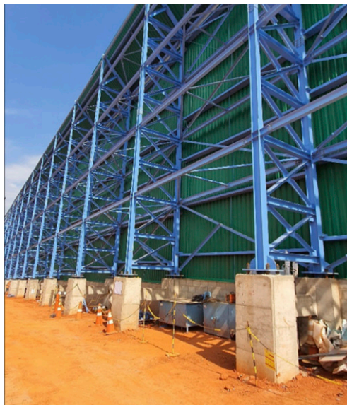
Figura 6: Vista interna da Barreira Acústica construída pela Kinross Brasil Mineração, Paracatu - MG. (Foto: do autor).
